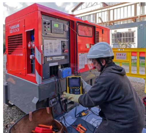
Electricien du spectacle @ CFPTS
